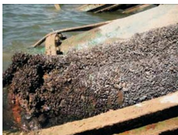
Tubería colonizada por mejillón cebra
